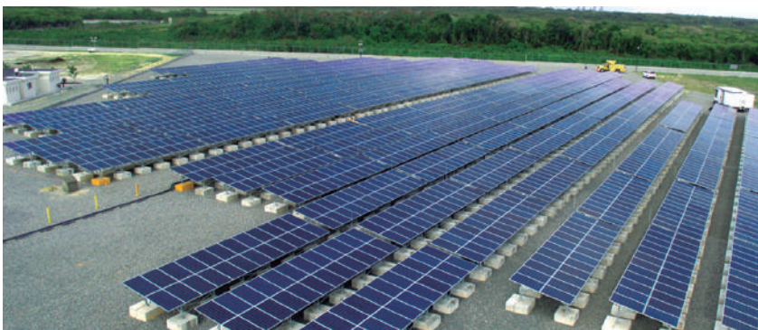
Inauguración de obras complementarias del complejo Norge Botello, marzo de 2017 , incluyendo la puesta en marcha de un sistema fotovoltaico de 1.0 Mega Watt para suministrar energía eléctrica a todo el complejo aeronáutico dominicano.
