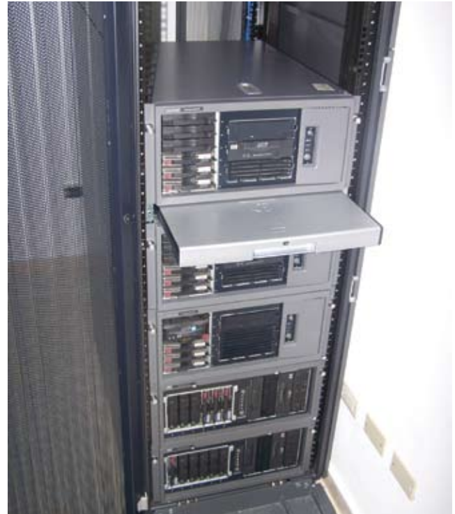
El IDAC adquirió recientemente un moderno servidor Rack HP de 42U que soporta el sistema OnBase, SIAR y todas las aplicaciones de informática.
